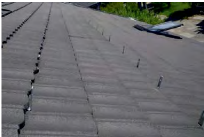
Obr. Konzoly „vystupujúce“ spod krytiny bez jej „prederavenia“
