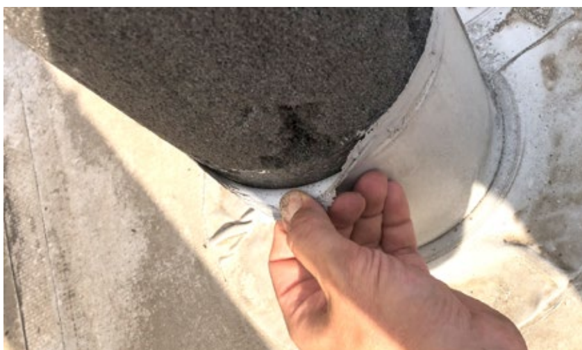
Obr. 6 Ukončenie povlakovej krytiny na tepelnej izolácii prestupujúceho potrubia ako zdroj penetrácie vody
