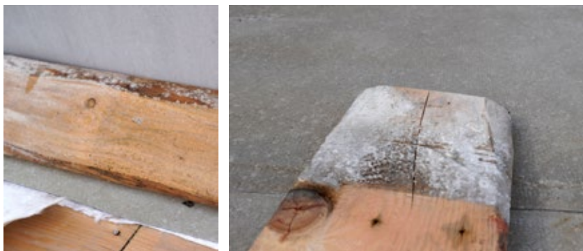
Obr. 4 Pleseň na doskách záklopu v blízkosti vetracieho otvoru a vpravo z miesta, kde nie je doriešená priebežná vetraná dutina
