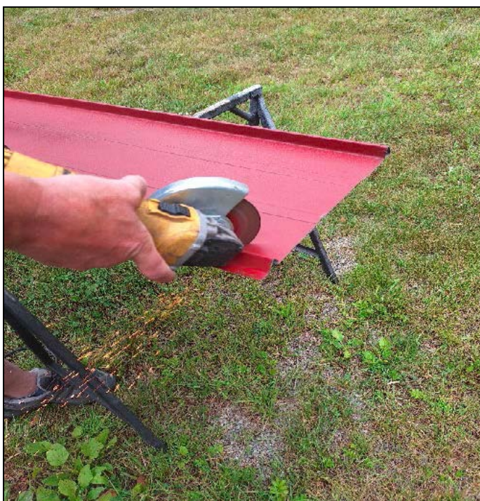
Zakázaný spôsob delenia oceľových lakoplastovaných krytín „teplým” spôsobom.
