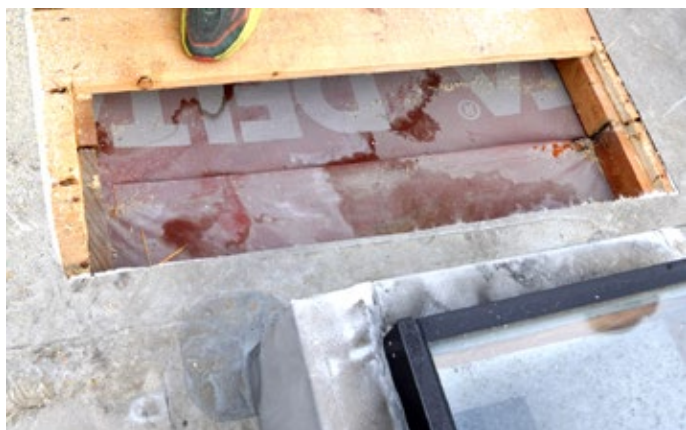
Obr. 2 Stopy po vyskytujúcich sa mláčkach na poistnej hydroizolácii pod výlezom na strechu v smere spádu strechy
