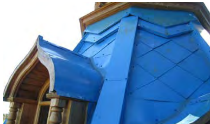
Obr. č. 23 - Ukážka vyhotovenia klmpiarskych konštrukcií na sakrálnom objekte bez znalosti poctivého remesla!
