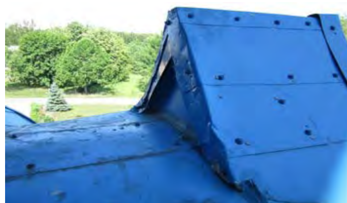
Obr. č. 24 - Ukážka vyhotovenia klmpiarskych konštrukcií na sakrálnom objekte bez znalosti poctivého remesla!
