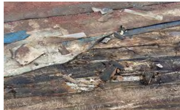
Obr. č. 9 - Pohľad na vlhkosťou znehodnotený drevený záklop, vplyvom nedostatočného prevetrávania strešného plášťa.
