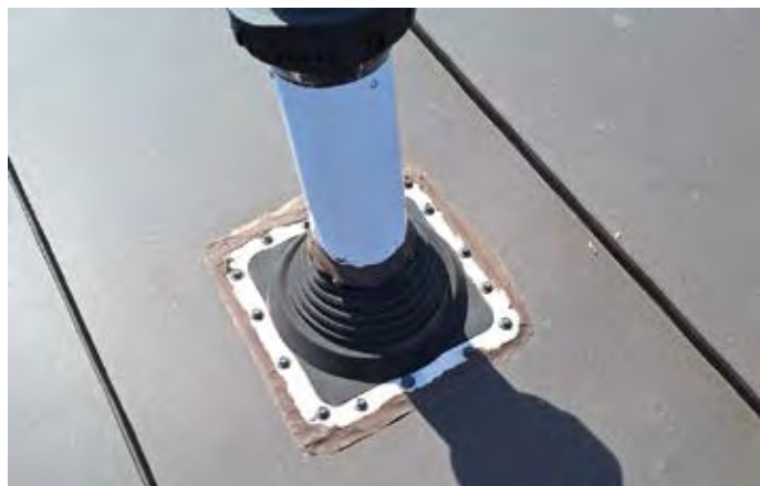
Obr. č. 18 - Pohľad na nesprávne oplechovanie bodového, kruhového prestupu do drážkovej krytiny.
