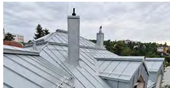
Obr. č. 25 - Ukážka spoľahlivého vyhotovenia klmpiarskych konštrukcií v ploche ako aj detailoch.
