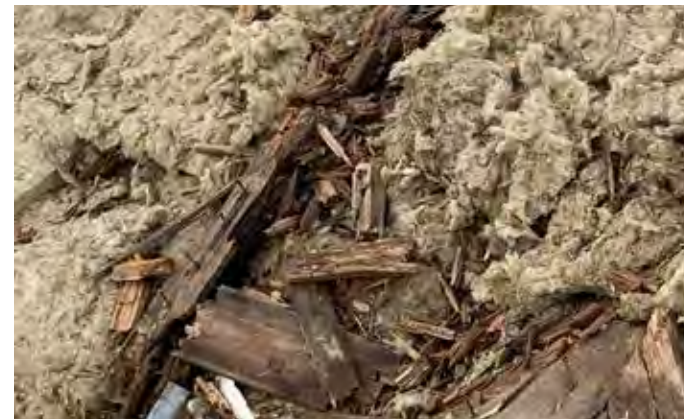
Obr. č. 8 - Pohľad na vlhkosťou znehodnotený nosný krov, vplyvom nedostatočného prevetrávania strešného plášťa.
