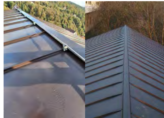
Obr. č. 11 a č. 12 - Pohľad na nespoľahlivé oplechovanie odvetrania v hrebeni.
