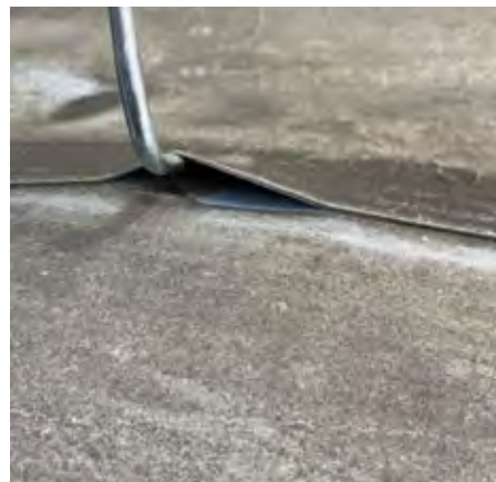
(studený spoj po iskrovej skúške)
