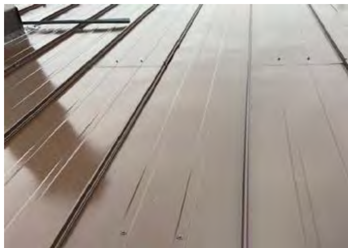
Obr. č. 16 - Ukážka nesprávneho vyhotovenia priečných spojov v závislosti od strešného sklonu, „klik“ systém.
