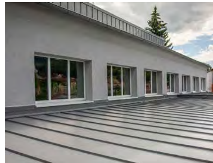
Obr. č. 13 - Pohľad na nespoľahlivé oplechovanie odvetrania pri zvislej stene.
