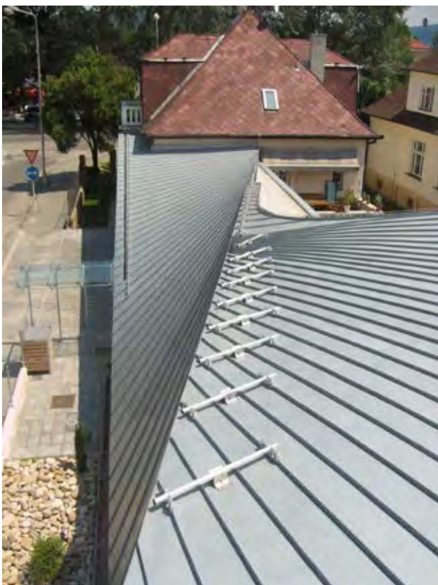
Vyhodenie klampiarskych prác na zastrešení a opláštení RD-u v Trenčíne (systém: RHEINZINK)
